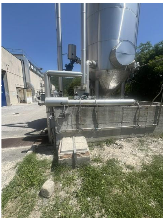
Figura 4 – Bacino di Contenimento del Kemfluid, con pozzetto che lo collega alla rete delle acque meteoriche.
