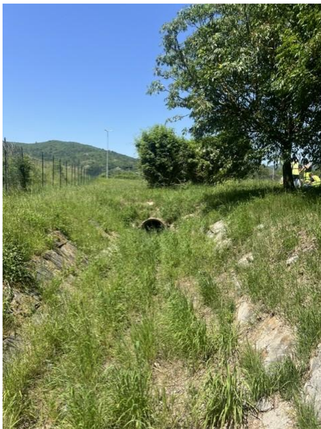
Figura 3 – Canale di raccolta acque di ruscellamento
