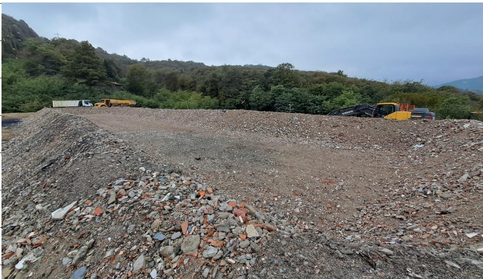
Foto 7 – Vista interna area di alloggiamento dei serbatoi espansibili di raccolta percolato
