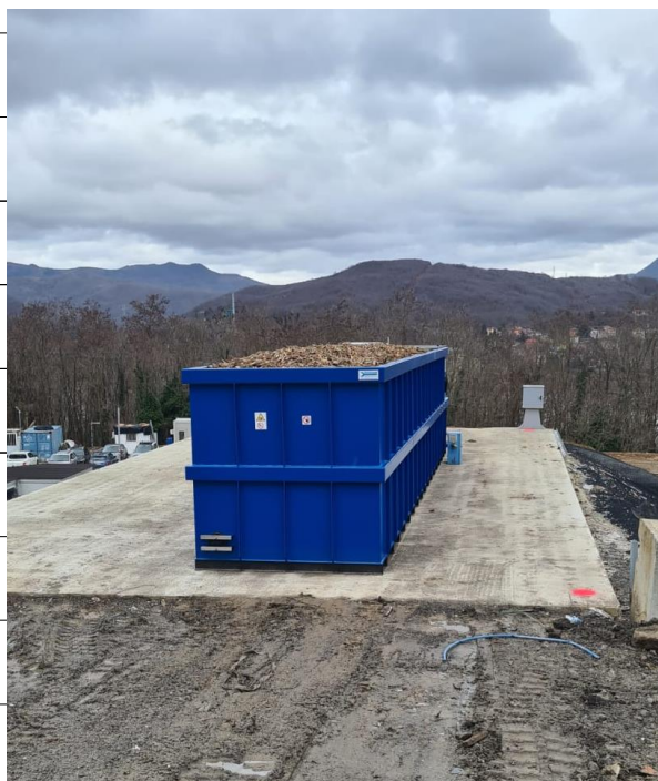
Foto 6– Biofiltro in container
