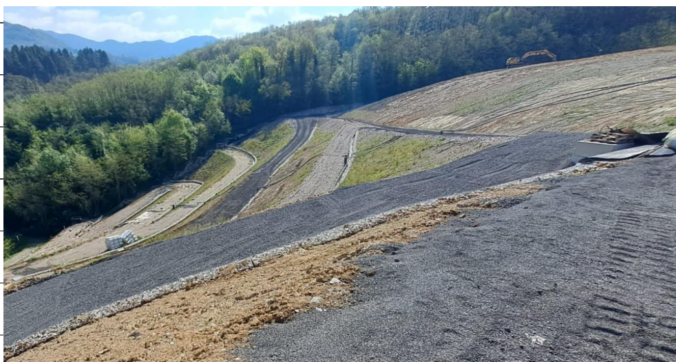
Foto 6 – Veduta zona nord della discarica, presenti le tubazioni di collettamento del biogas collegate alle teste di pozzo e dirette verso la prima sottostazione di regolazione
