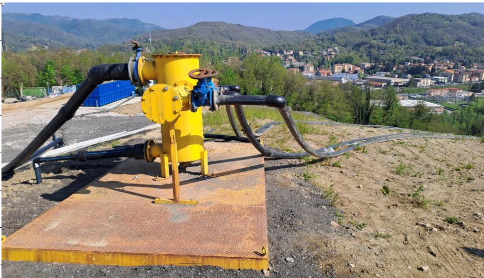
Foto 7 – Prima sottostazione di regolazione a cui sono collegate le tubazioni provenienti dalla zona nord della discarica
